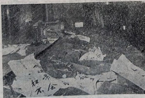
被“联动”分子破坏的公安部礼堂现场。
